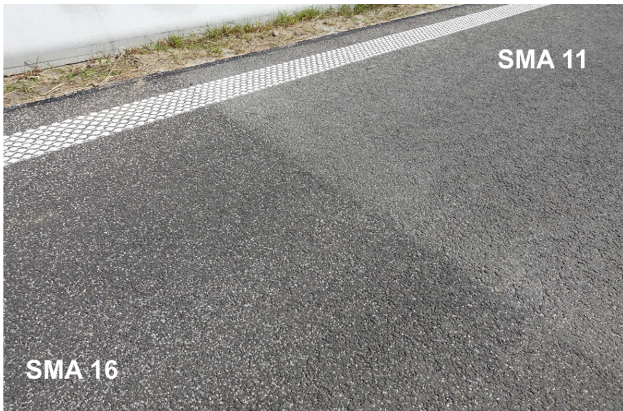
Rys. 7.3. Widok styku nawierzchni SMA 16 i SMA 11, obwodnica Jarocina (fot. B.Bogdański)
