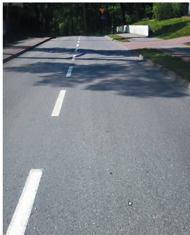
nawierzchnia po 7 latach eksploatacji
